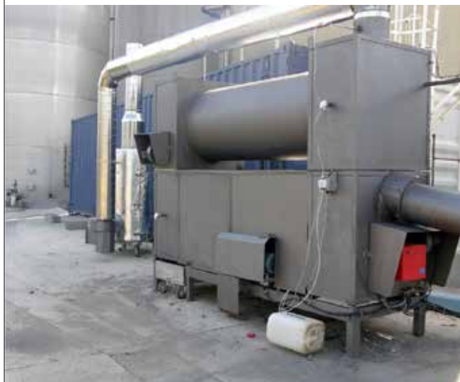
Figura 7. Horno rotatorio [parte inferior] y cámara de postcombustión
