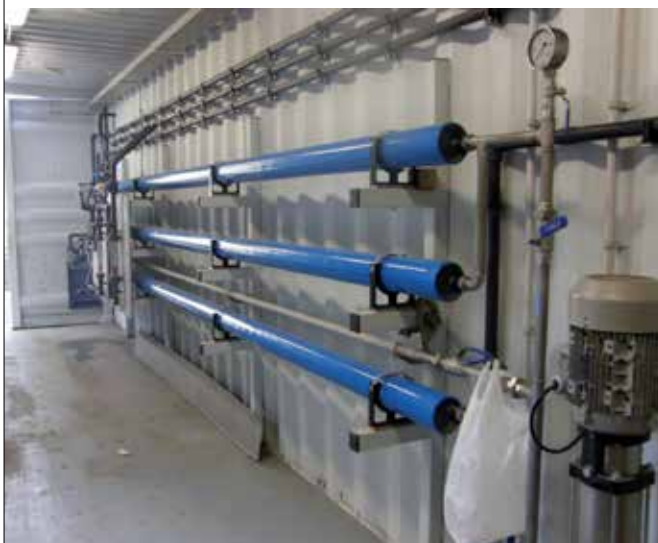
Figura 4. Módulos de ósmosis inversa
